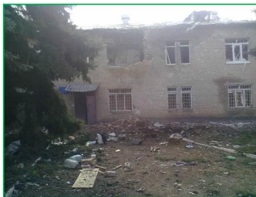
Разрушенное при боевых действиях здание ЭНЦ, 2014 год
